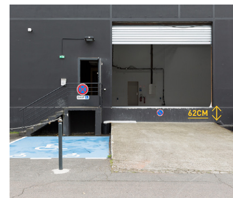
ACCÈS EXTÉRIEUR, MARCHE D'UNE HAUTEUR DE 62CM
